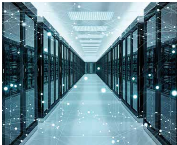
Figura 2. El cableado de fibra óptica optimiza la transmisión de datos en centros informáticos
